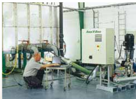
Test einer Pumpstation bei Rain Bird Schweden
